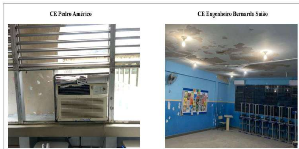
Figura 10 - Problemas na Infraestrutura nas Escolas da SEEDUC/RJ
