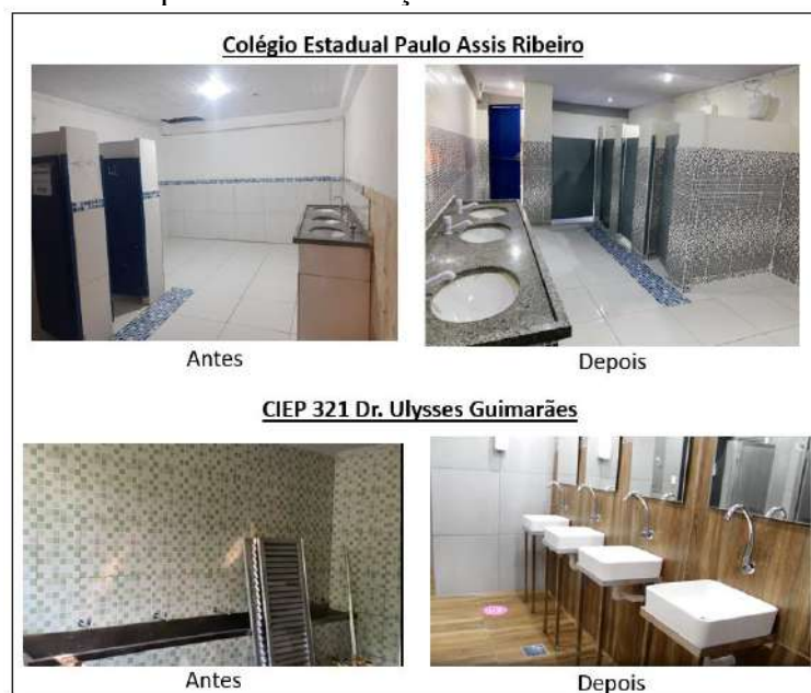
Figura 27 - Banheiro do CE Paulo Assis Ribeiro e CIEP 321 Dr. Ulysses Guimarães antes e depois das intervenções em infraestrutura
