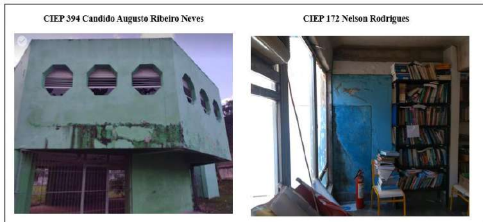
Figura 8 - Problemas na Infraestrutura nas Escolas da SEEDUC/RJ
