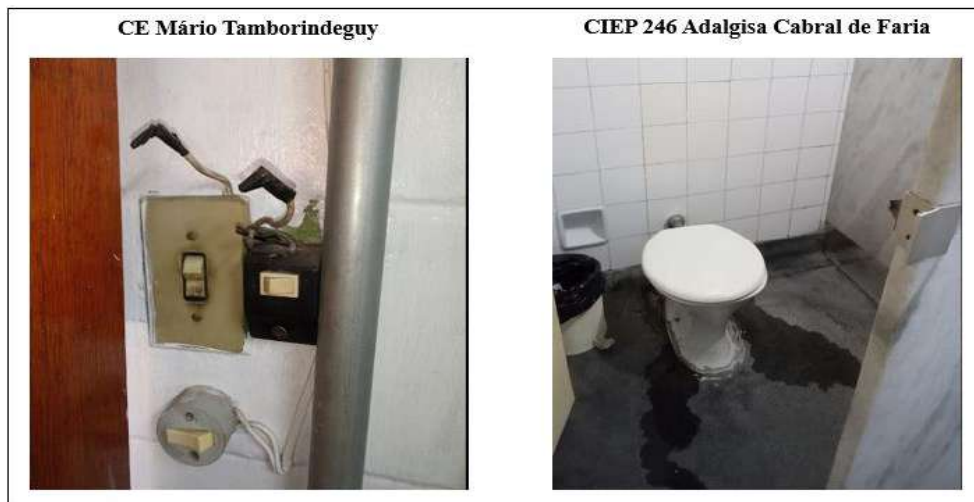
Figura 9 - Problemas na Infraestrutura nas Escolas da SEEDUC/RJ
