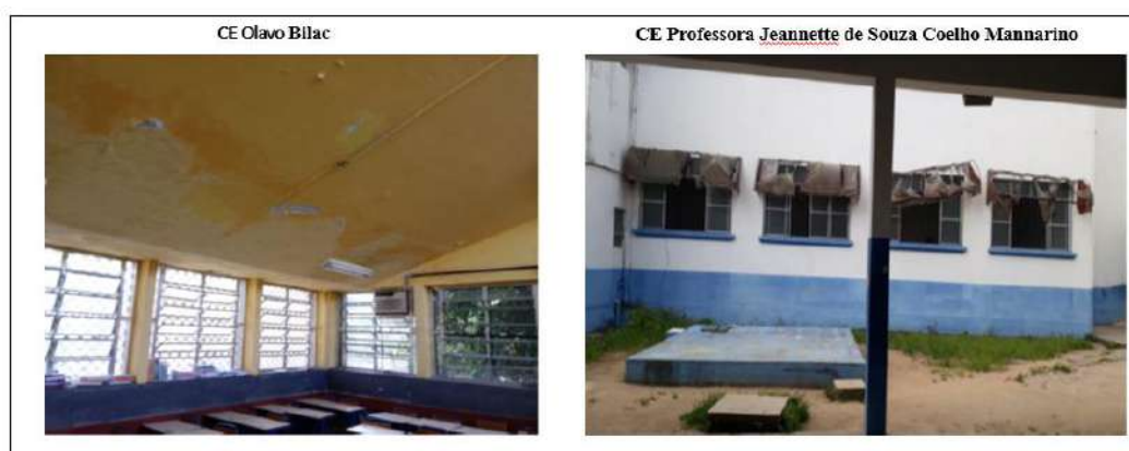
Figura 7 - Problemas na Infraestrutura das Escolas da SEEDUC/RJ
