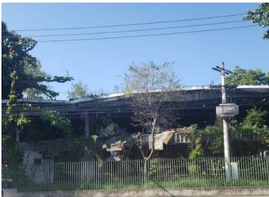
Figura 46 – Fachada frontal do Parque Ary Barroso; estrutura da PMERJ incendiada
