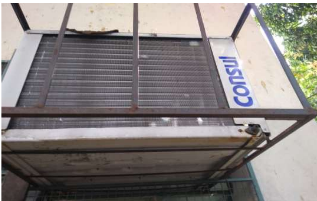
Figura 43: Aparelho de ar condicionado da sala de aula. Sugestão: canalizar a água do ar condicionado para ser reutilizada. Fonte: Gilson Lima, 2018.
