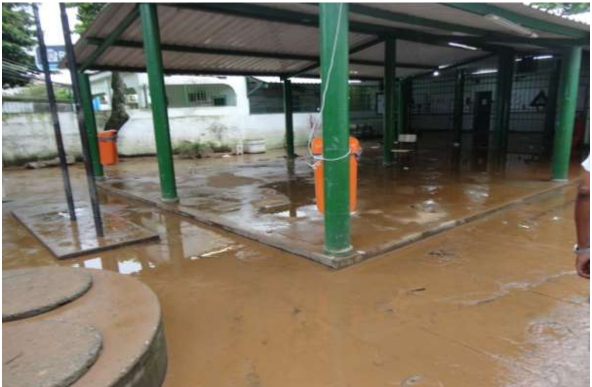
Figura 2: Pátio externo da E.M. Alberto José Sampaio, após última grande enchente no bairro da Pavuna em 11/12/2013. Fonte: Arquivo pessoal, 2013.
