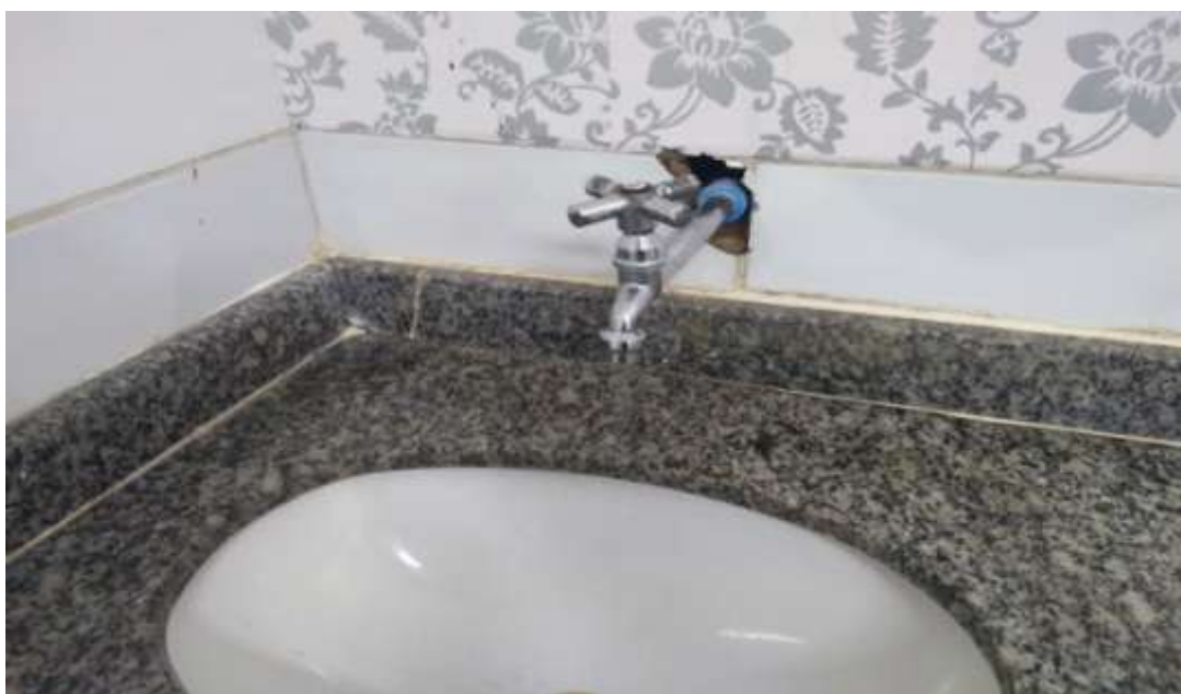
Figura 42: Torneira do banheiro feminino da EMAJS. Sugestão: trocar por uma automática. Fonte: Débora de Oliveira, 2018.
