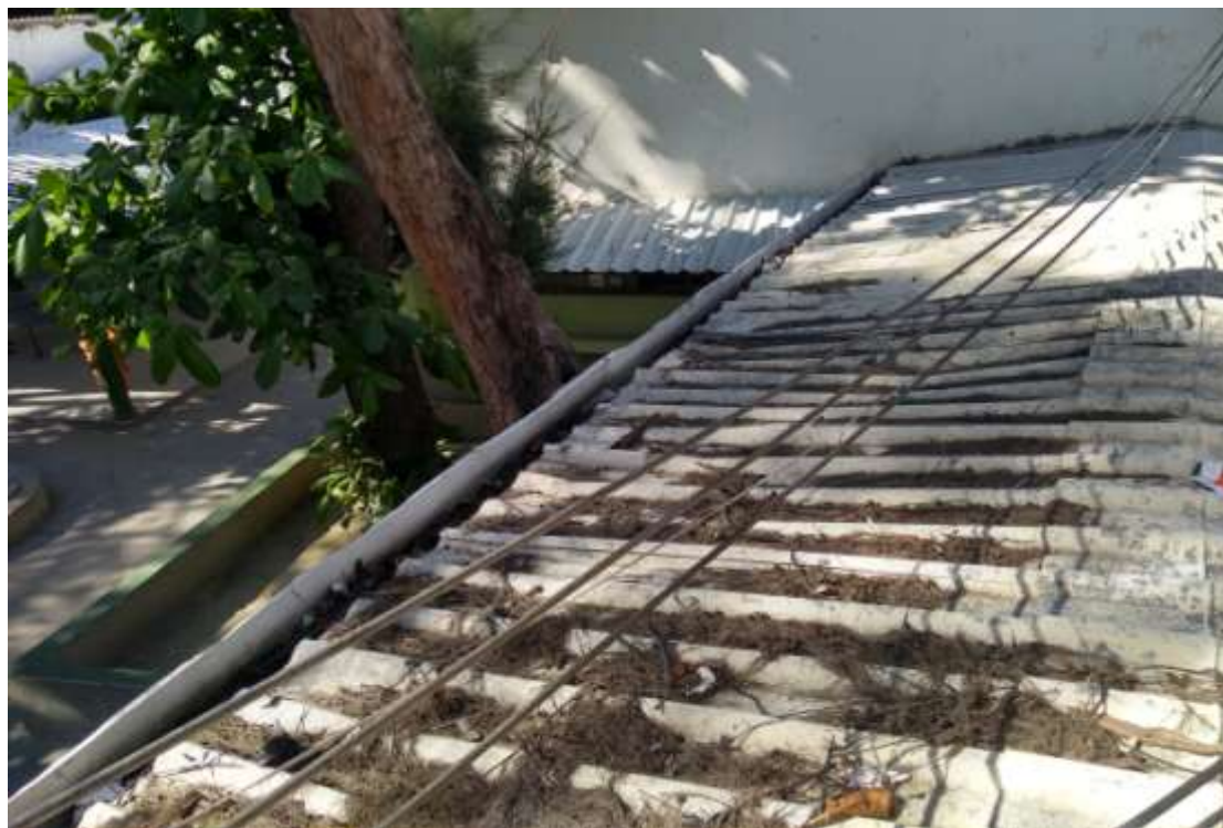
Figura 44: Calha do telhado da EMAJS. Sugestão: reaproveitamento da água da chuva utilizando algum tipo de reservatório. Fonte: Juliano Menezes, 2018.
