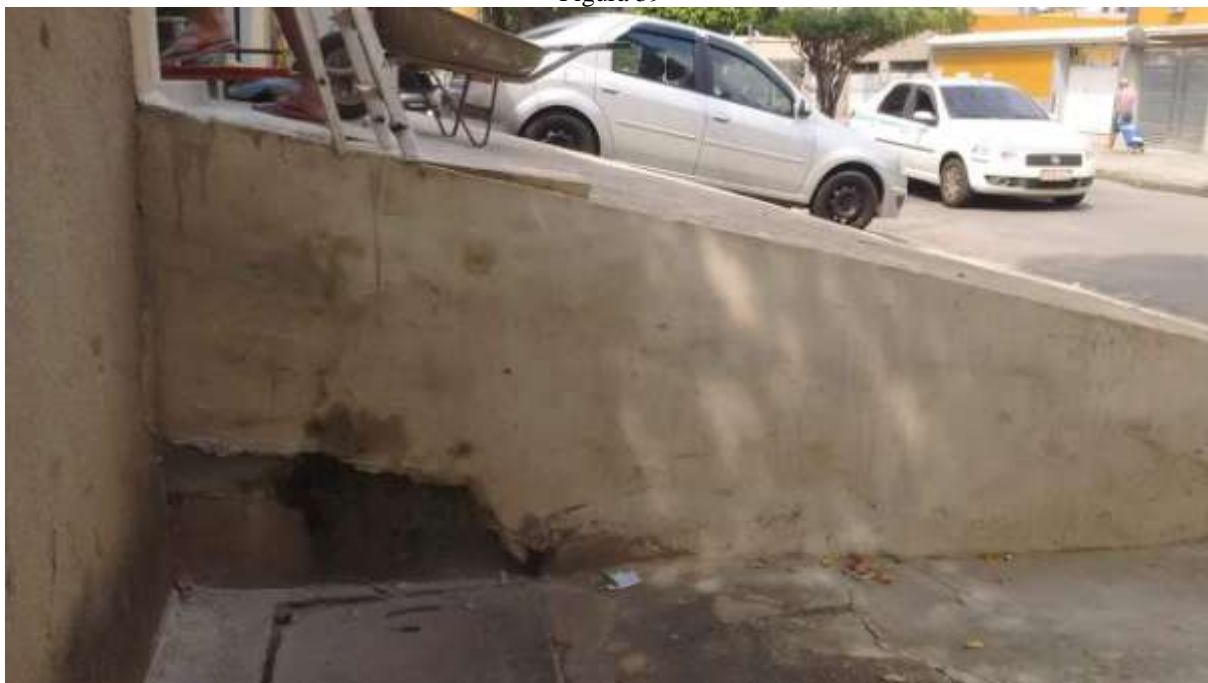
Figura 39: Calçadas com altíssimas rampas de acesso às residências. Foto: Arquivo pessoal, 2018.
